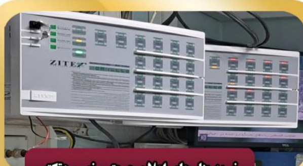
خرید پنل های اعلان حریق و نصب دتکتور
