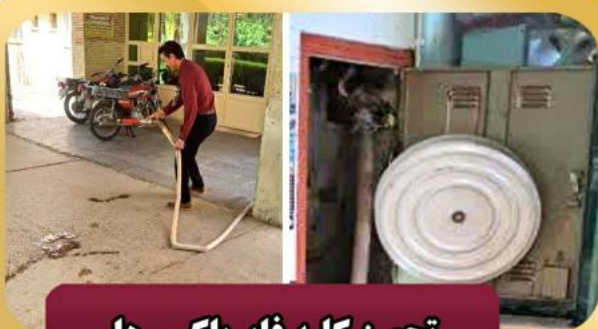
تجهیز کلیه فایرباکس ها
